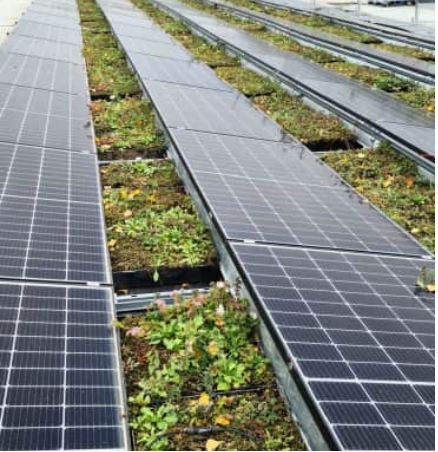
Toiture Panneaux PV
